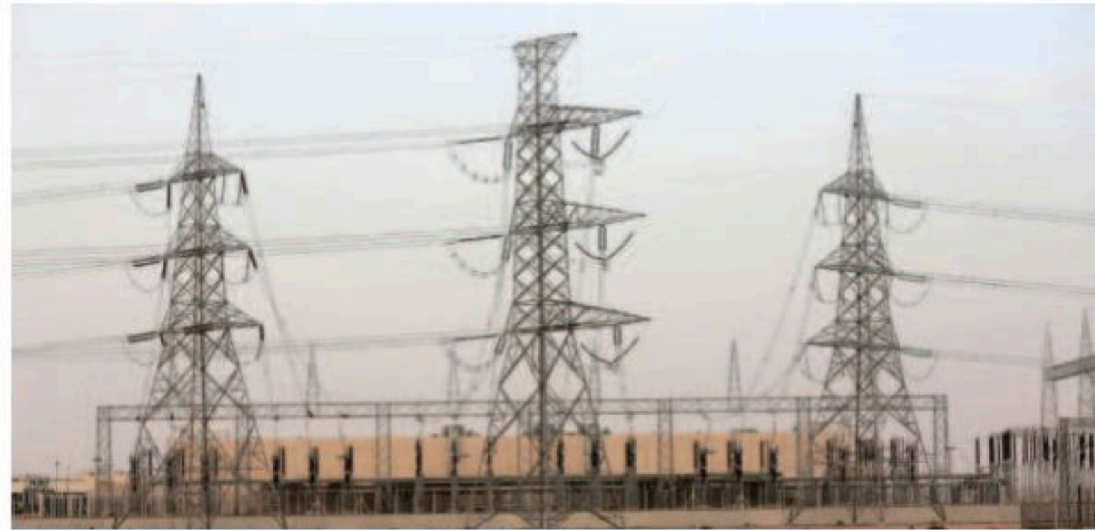
محطة سدير لتحويل الكهرباء
