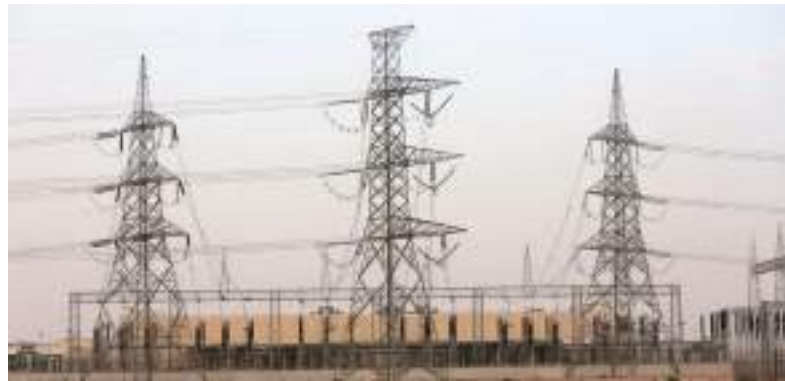
محطة سدبر لتحويل الكهرباء
