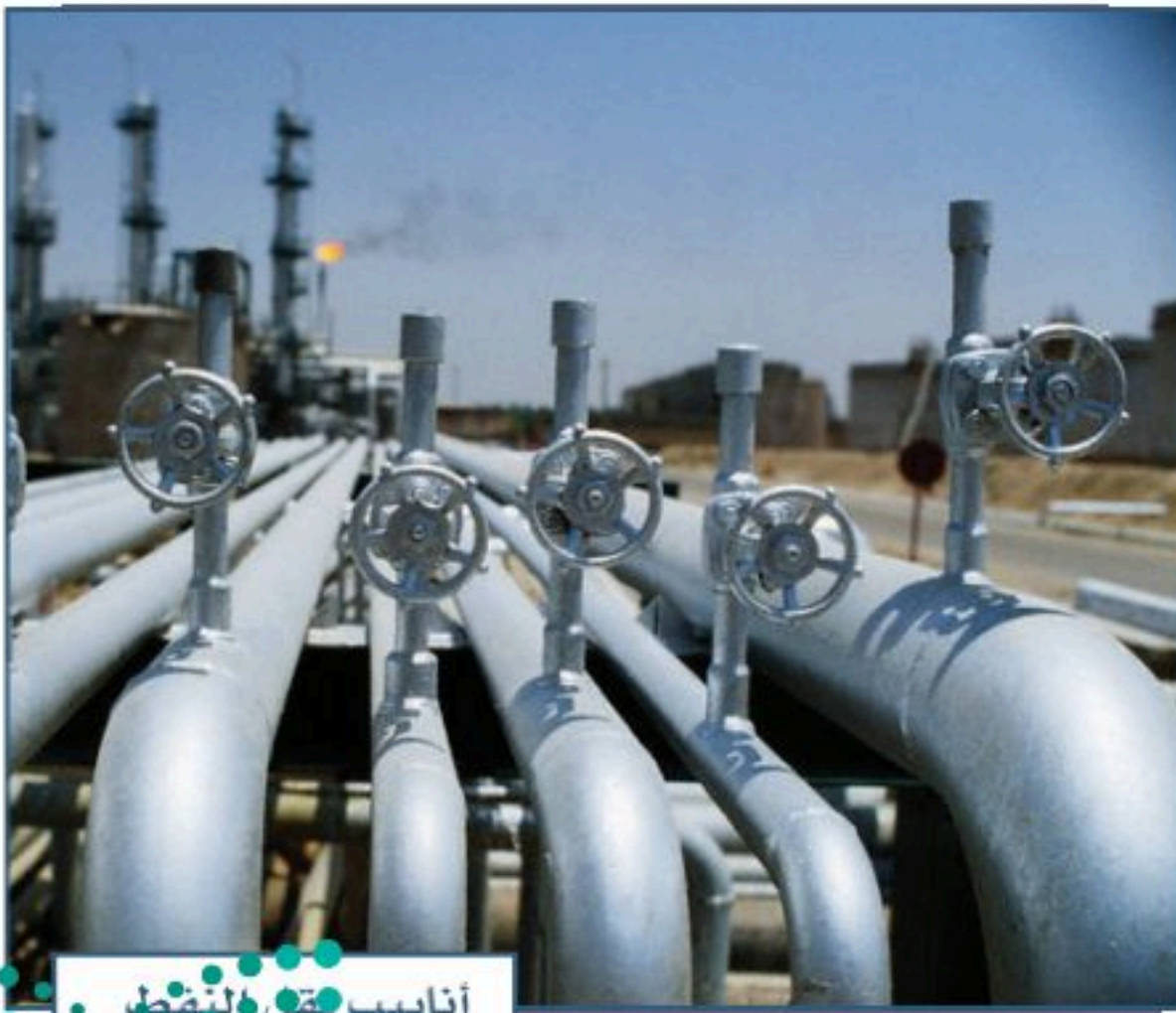
أنابيب نقل النفط
